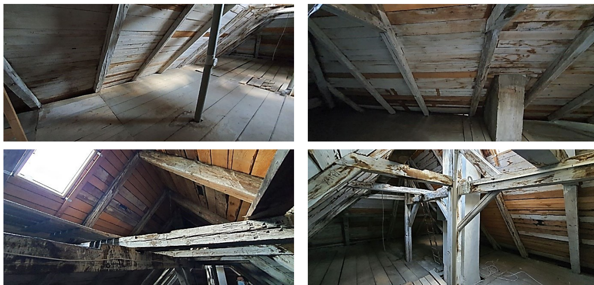
Obrázek 16, 17, 18, 19 – Pohled na oslabenou stávající dřevěnou podvrcholovou vaznici a stávající dřevěný sloupek u pravého komína
