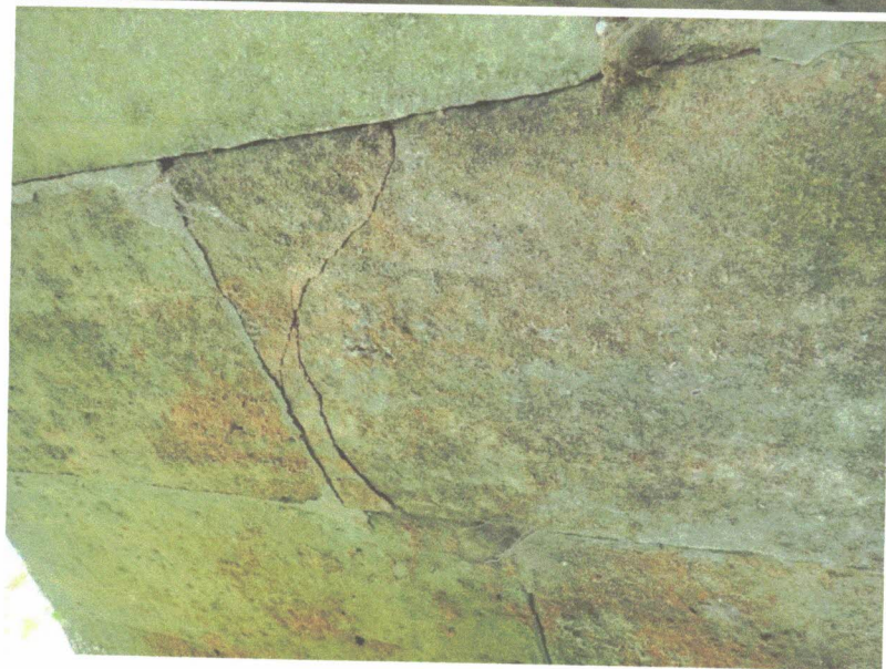
Trhlina v kamenném bloku klenby nad pravobřežní opěrou
