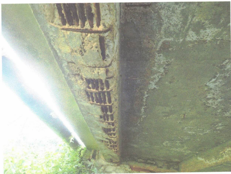
Odpadá krycí vrstva betonu v pohledu trámu na výtoku
