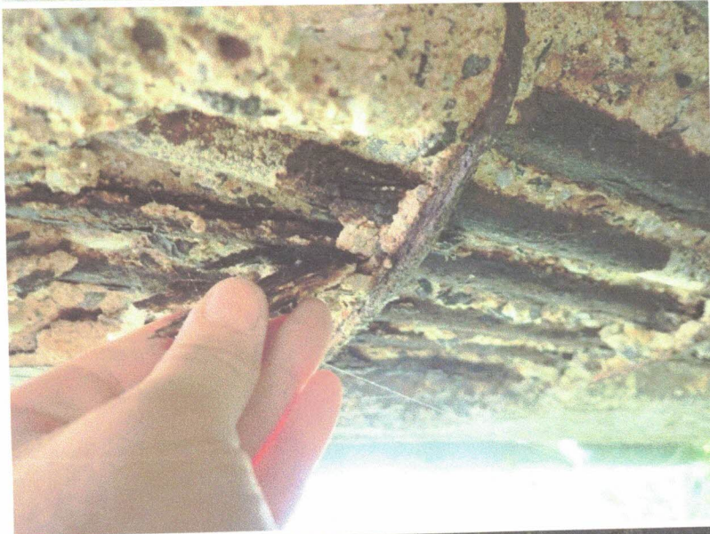
Koroze odhalené výztuže trámu NK.
