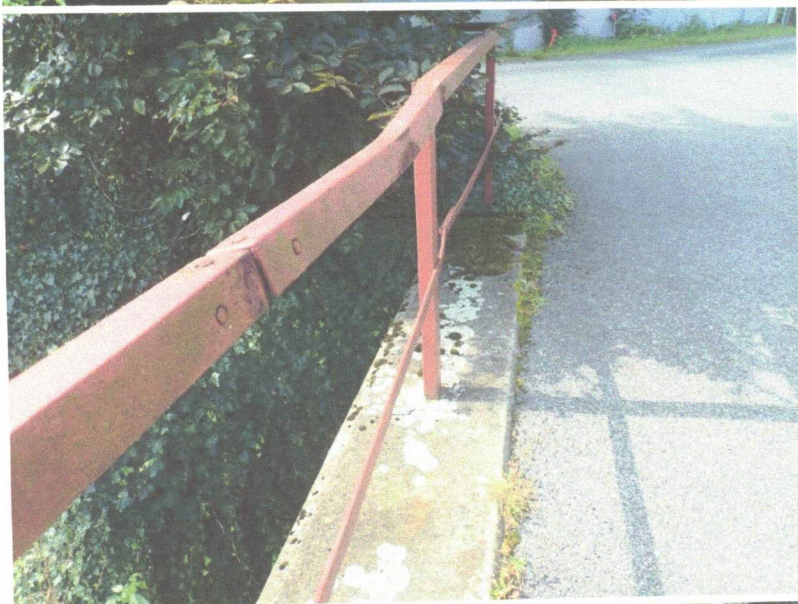
Římsa na výtoku před pravobřežní opěrrou, deformace zábradlí
