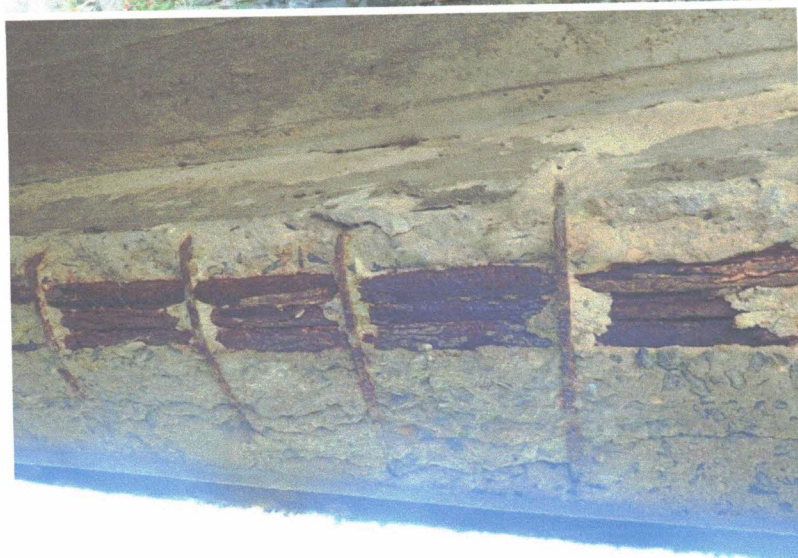
Podhled trámu na vtoku, odpadlá krycí vrstva betonu, korodující nosná výztuž
