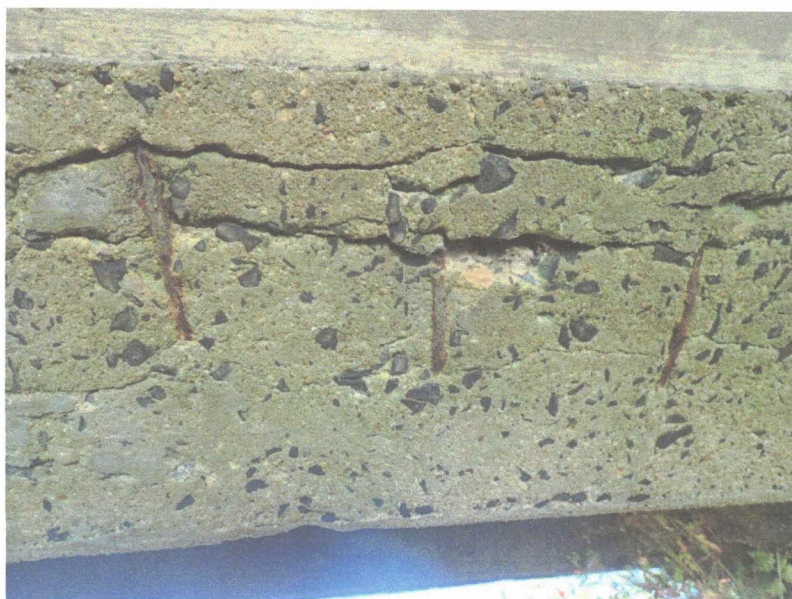
Trhliny v pohledu trámu
