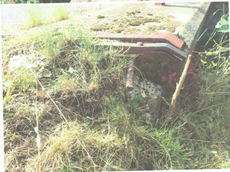
Chybějící část vtokové římsy
