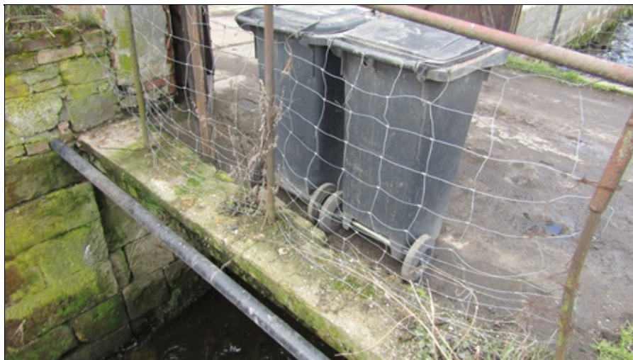
Pohled na levé zábradlí (ve směru staničení) - plošná povrchová koroze zábradlí, improvizovaná výplň
