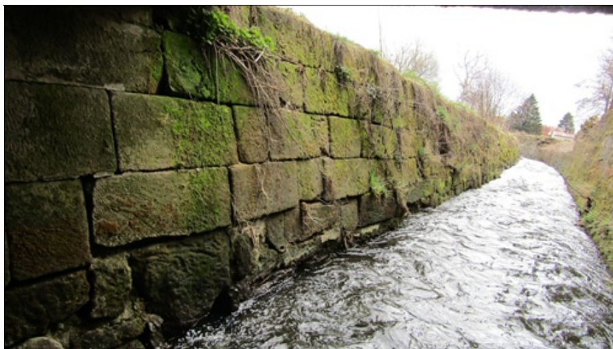
Levé křídlo O1 - vydrolení spárování zdiva, rašící vegetace ve zdivu, uchycený mech na povrchu zdících prvků
