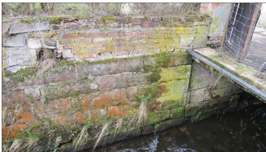
Levé křídlo O2 - vydrolené spárování, prorůstající vegetace spárou zdiva
