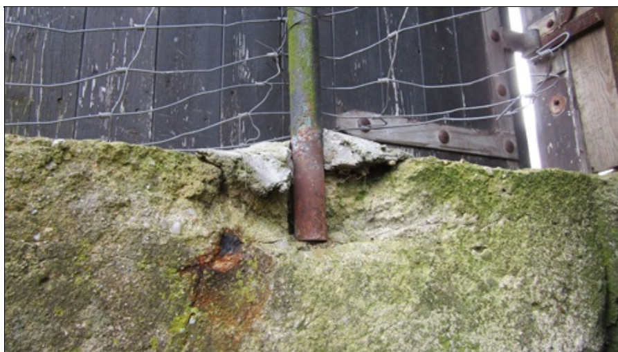
Detail uchycení sloupku v římsě (pravá římsa) - uvolněný sloupek zábradlí (utržená kapsa)
