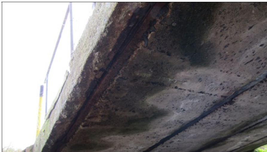
Podhled NK u pravého kraje - zatékání na bok NK přes římsu, odtržená hrana římsy
