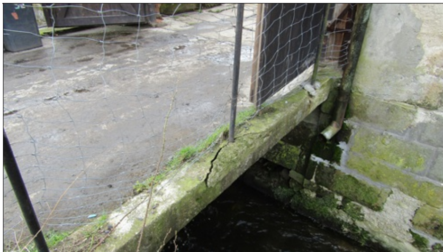
Pohled na pravou římsu (ve směru staničení) - travní vegetace uchycená na rozhraní římsy a mostovky, odtržená kapsa uchycení sloupku zábradlí, sinice na povrchu římsy
