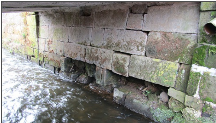
Pohled na zhlaví O2 - chybí celé zdící prvky v druhé řadě v cca 1/2 délky opěry
