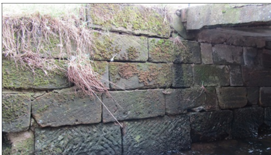
Pravé křídlo O1 - vegetace ve zdivu, vydrolené spárování
