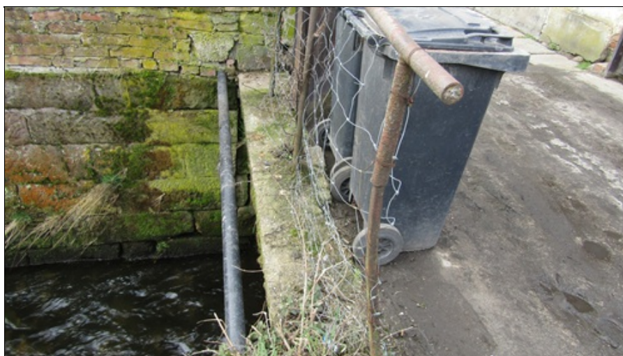
Pohled na levou římsu (ve směru staničení) - plošná povrchová degradace povrchu, deformace krajního sloupku
