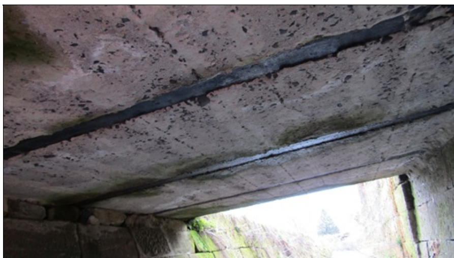
Podhled NK od O2 (pravá strana) - zavlhá místa podél tuhých vložek, v těchto místech uchycené sinice, plošná povrchová degradace betonu
