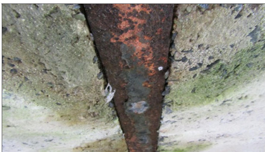
Detail podhledu NK - dolní pásnice válcovaného profilu – celoplošná koroze tuhé vložky
