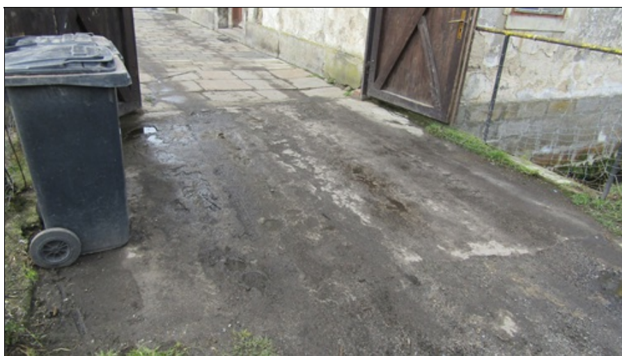
Pohled na povrch mostovky (ve směru staničení) - výtluky na horním povrchu NK, travní vegetace uchycená na rozhraní římsy a mostovky
