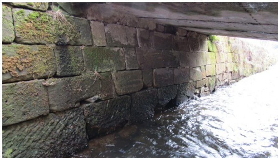
Pohled na zhlaví O1 - vydrolení spárování zdiva, rašící vegetace ve zdivu, uchycený mech na povrchu zdících prvků, lokálně odtržené části kamenného zdícího bloku
