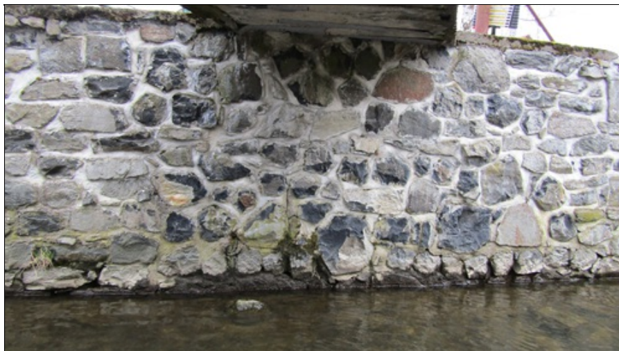
Pohled na zhlaví O1 - lokálně rašící travní vegetace
