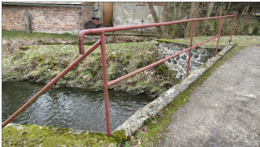
Pohled na levé zábradlí (ve směru staničení) - v krajním poli levého zábradlí chybí výplň
