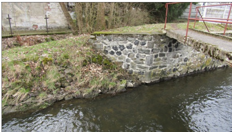
Levé křídlo O2 - uchycený mech na koruně křídla, odhalení podélné výztuže římsy, uvolněný sloupek zábradlí
