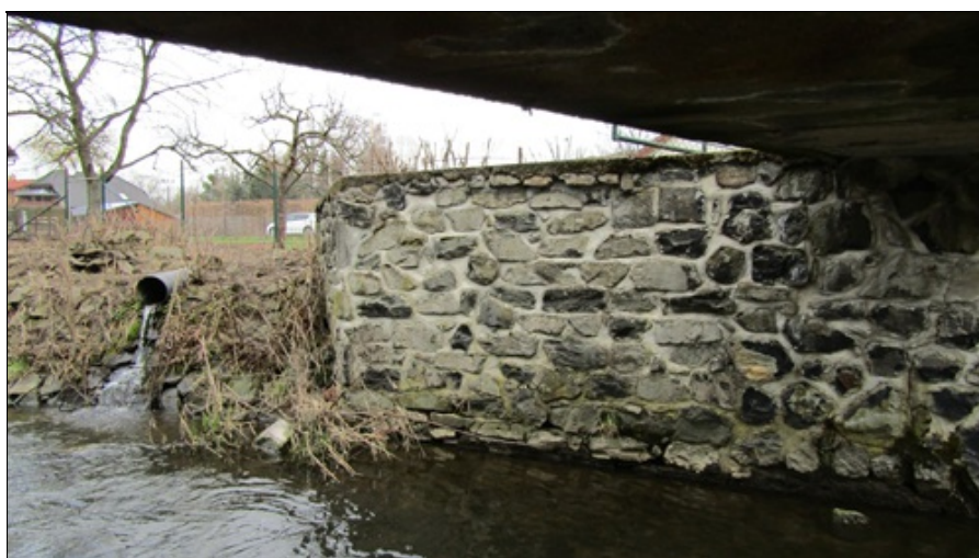
Pravé křídlo O1 - naplaveniny před křídlem
