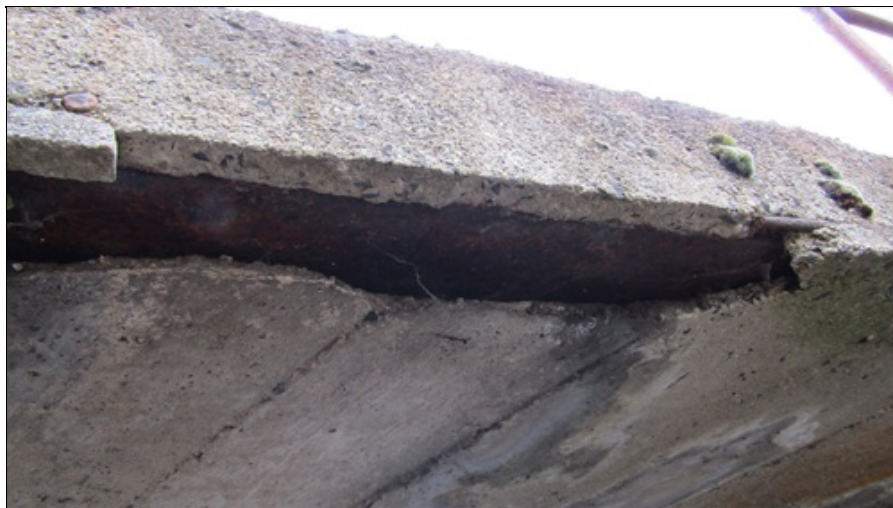
Detail levé hrany NK - lokální odtržení krycí vrstvy, odhalení tuhé výztuže
