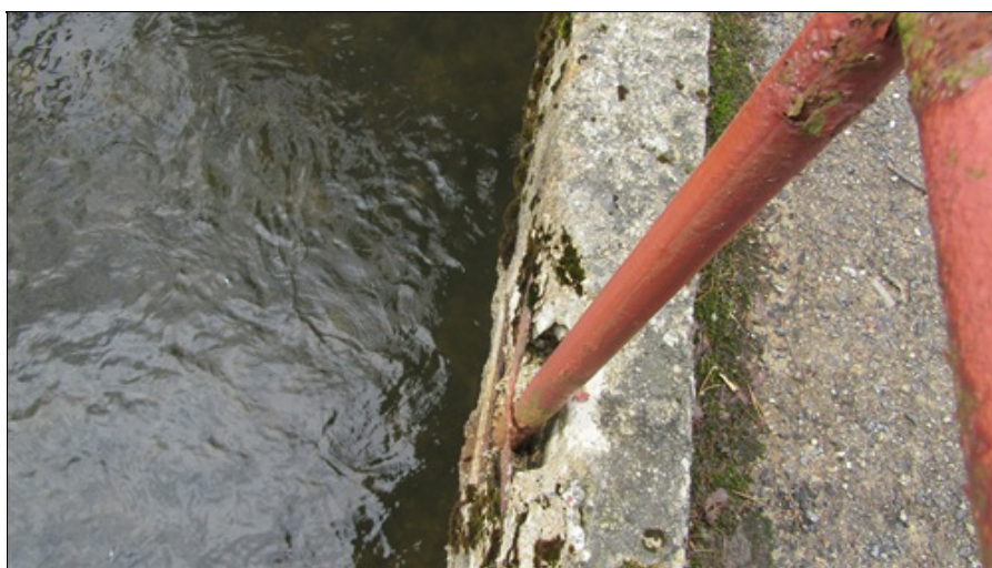
Detail levého sloupku zábradlí - uvolněný sloupek zábradlí, lokální poškození PKO
