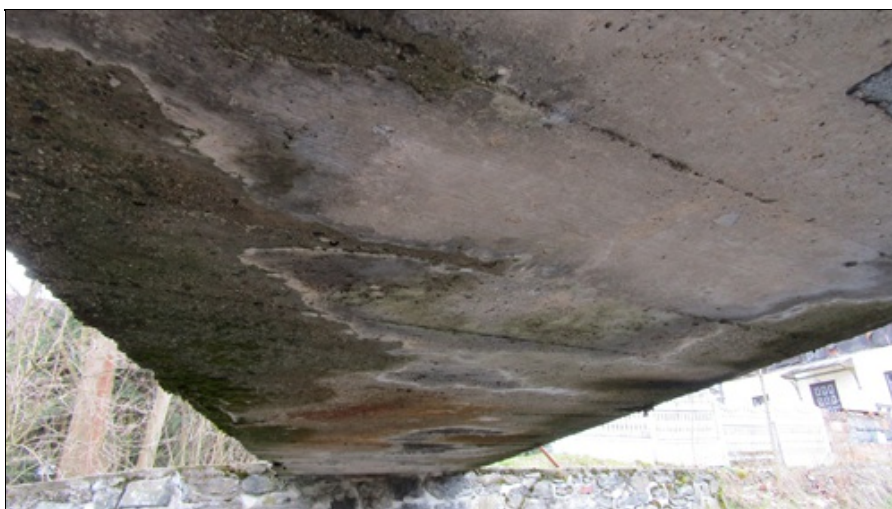
Podhled NK od OP1 - povrchová degradace betonu, tvorba cementových výluhů, mech na podhledu
