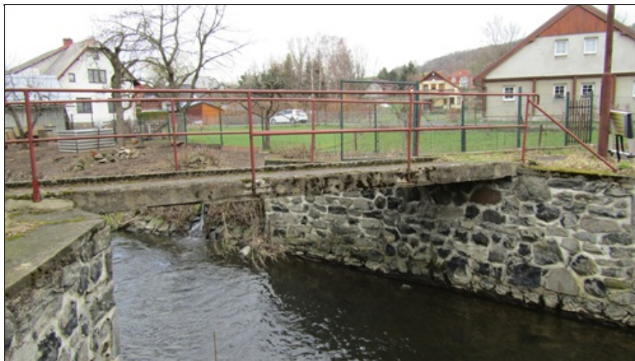
Pohled zleva (proti směru staničení) - mech uchycený na svislém povrchu římsy
