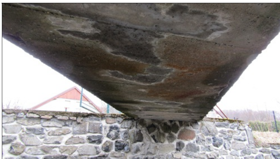
Podhled NK od OP2 - povrchová degradace betonu, tvorba cementových výluhů, mech na podhledu
