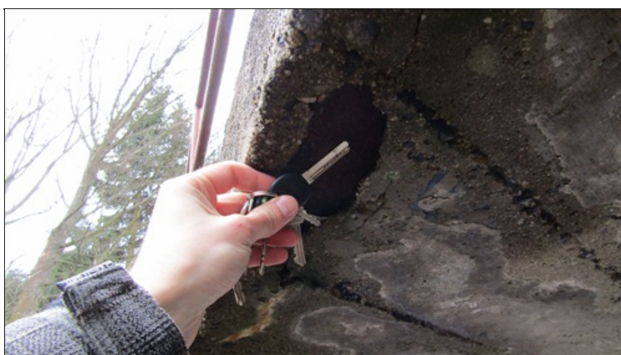
Detail NK - lokální odtržení krycí vrstvy, odhalení tuhé výztuže
