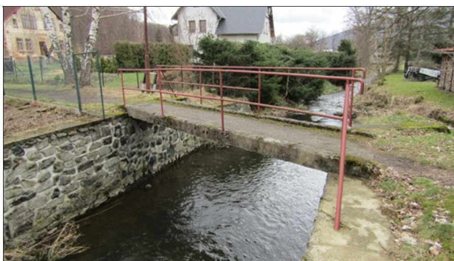
Pohled zprava (proti směru staničení) - mech uchycený na svislém povrchu římsy
