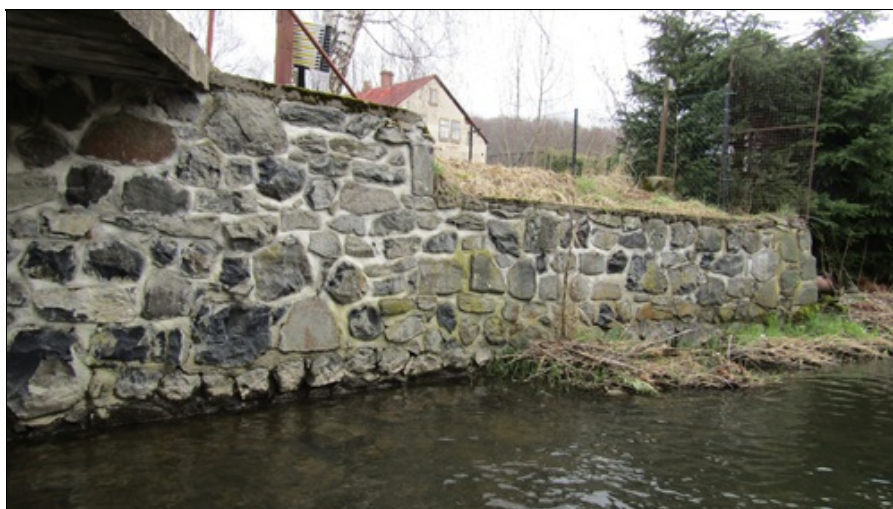
Levé křídlo O1 - naplaveniny před křídlem
