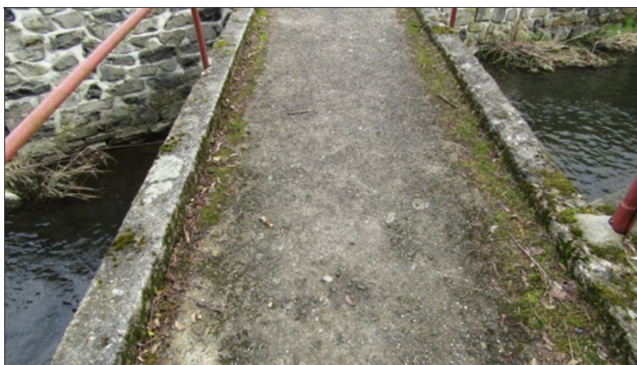
Pohled na mostovku (proti směru staničení) - po celé délce zvýšené hrany římsy je uchycen mech, mech uchycený na povrchu říms
