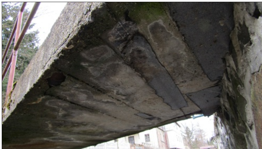
Podhled NK u O1 - povrchová degradace betonu, tvorba cementových výluhů, odtržená krycí vrstva
